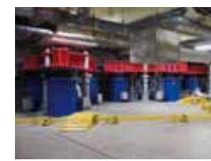
▲「知幹館」の地下に設置された世界初の3次元免振装置
